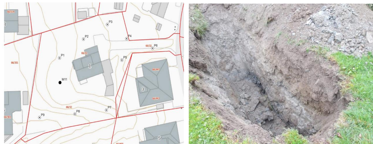
Figur 3: Utklipp av prøvegravingsplan og bilde fra ett av gravepunktene. Kilde: DMR Miljø og Geoteknikk AS
